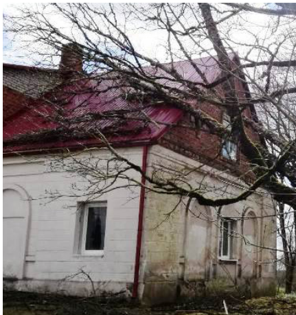
Uz pašvaldības ēkas Kalnāji jumta uzgāzies koks
