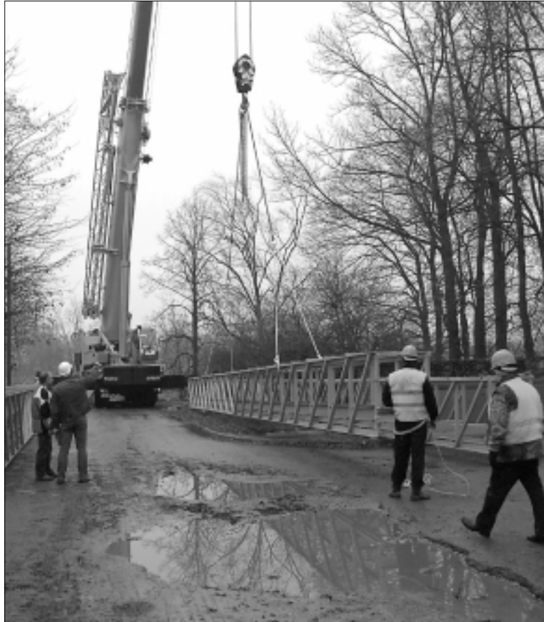
Jaunais tilts - tikai ūdensvadam. Staigāt nedrīkst!
