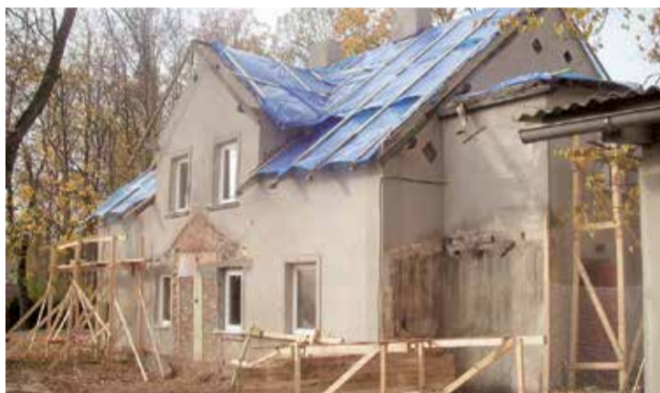
Dienas centra ēka 2006. gadā. Notiek renovācijas darbi un taps dienas centrs, kādu to zinām šodien. Foto no dienas centra arhīva
