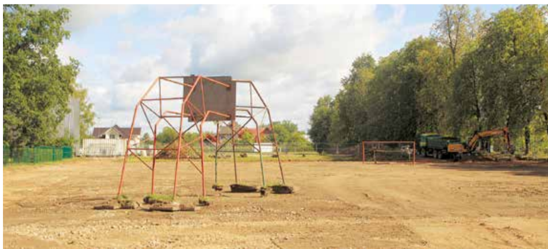
Topošajā sporta laukumā jau nolīdzināts būvniecības laukums un tiek novāktas pēdējās vecā sporta laukuma konstrukcijas. Aleksandra Čerņavska foto
